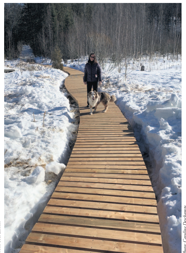
Après deux jours de durs travaux, la réfection de la passerelle est terminée. On voit ici une utilisatrice très heureuse de profiter de cette belle amélioration
