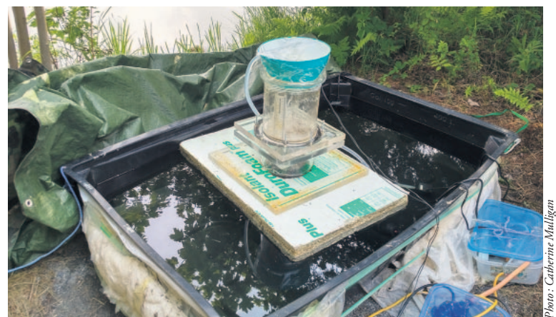
Le prototype de ce fameux projet de filtration des eaux installé, par les spécialistes, sur la rive des lacs.
